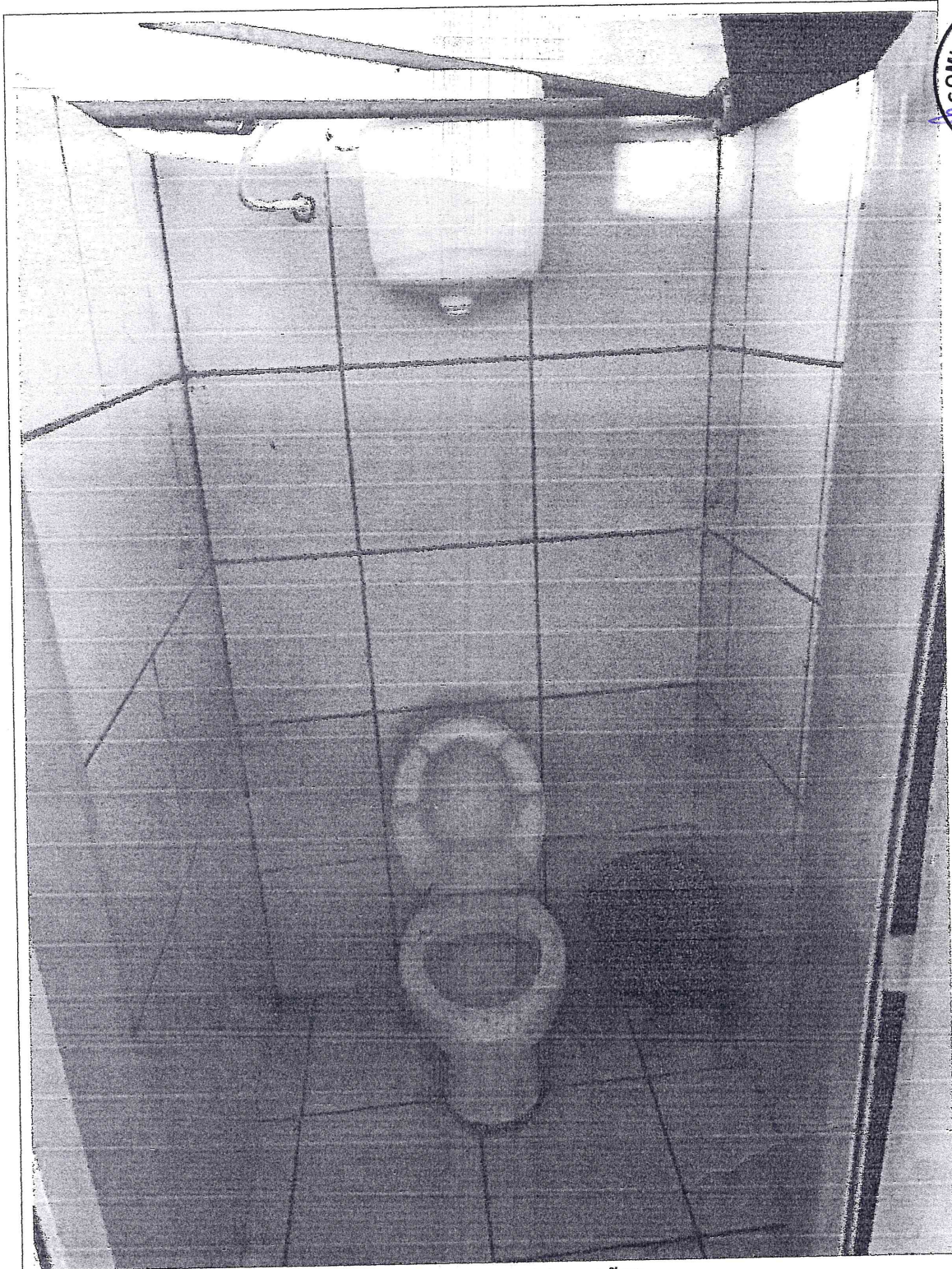
4-BANHEIRO SEM TUBULAÇÕES
