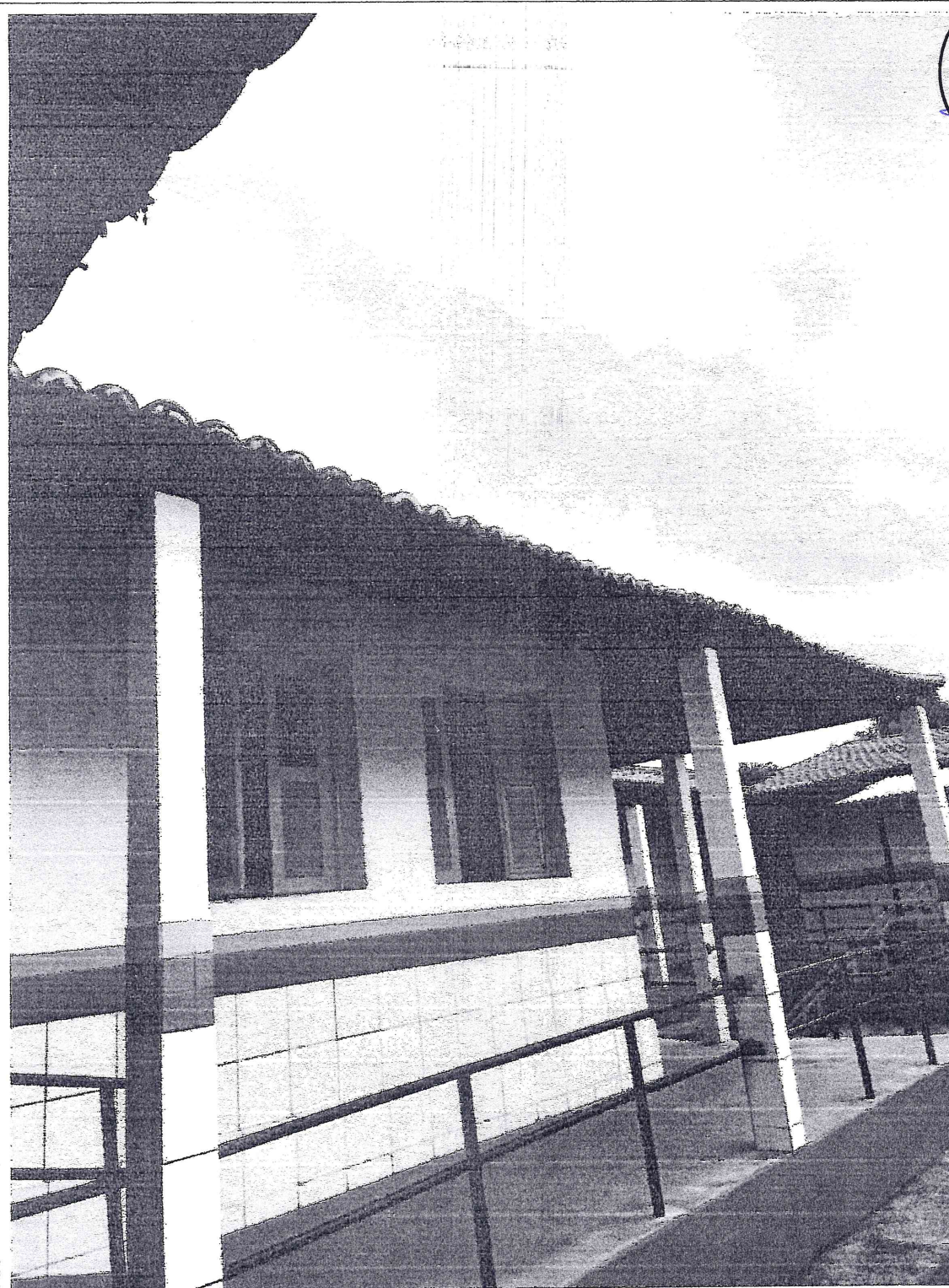
7- CAIBROS, TERÇAS E RIPAS EM RISCO
