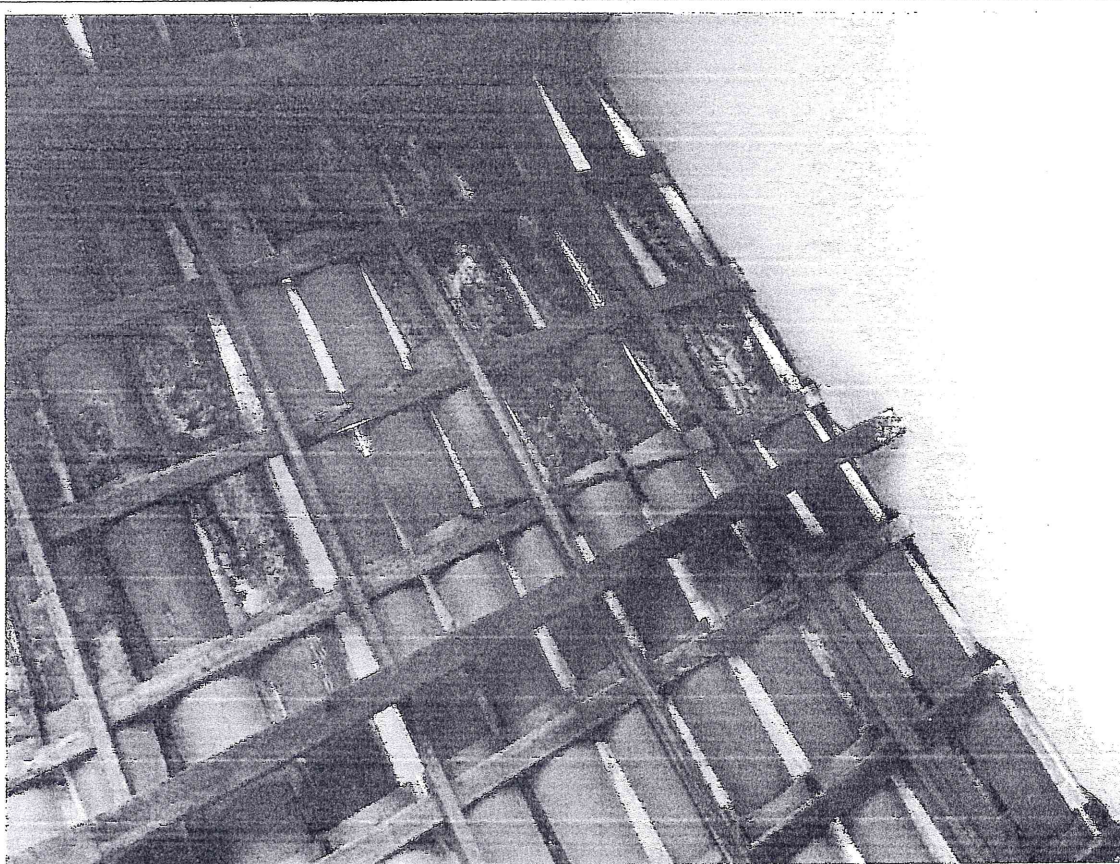
2-TELHADO COM INFILTRAÇÃO
