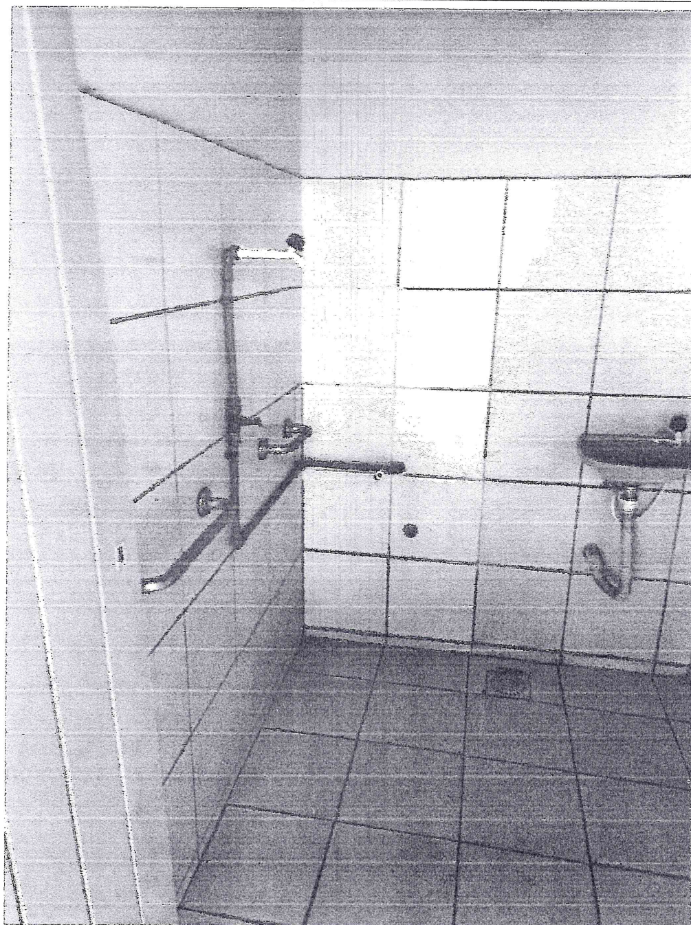
5-MAL FUNCIONAMENTO DE PONTOS HIDRÁULICOS
